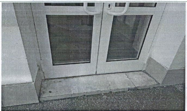
Фото №31 - Вход в здание эвакуационный (порог)
